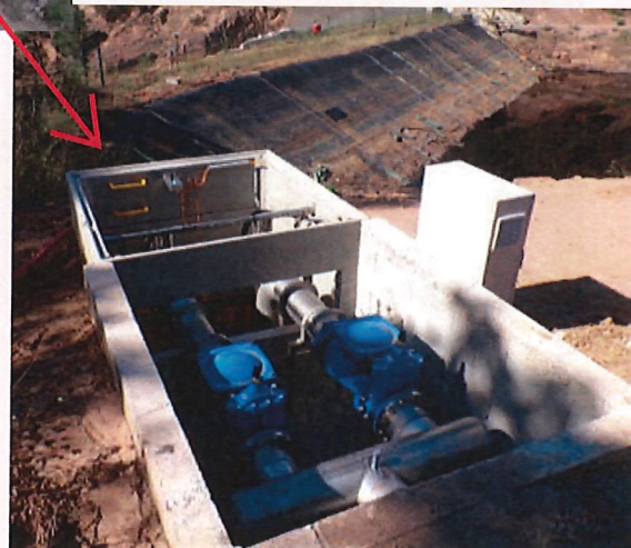
Chambre des vannes lagune (pompes)
