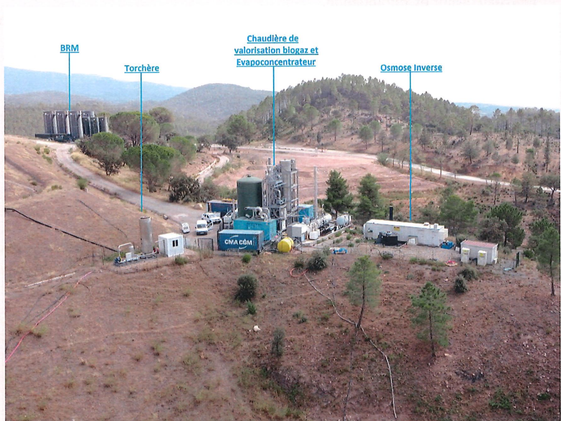
Equipements de traitement des lixiviats
