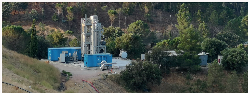
Evapo Concentrateur et chaudière à biogaz
