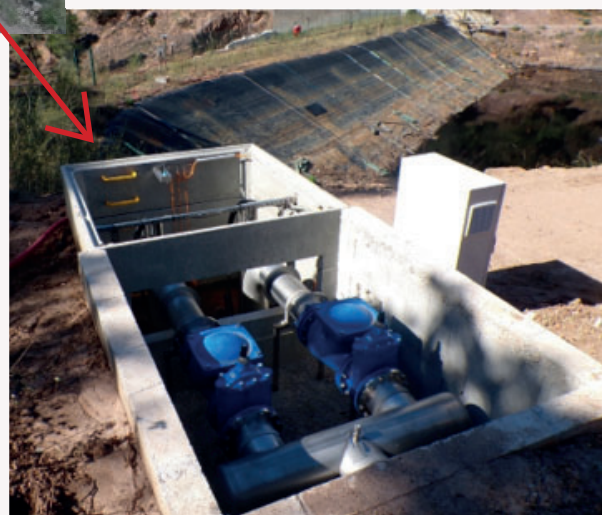
Chambre des vannes lagune (pompes)
