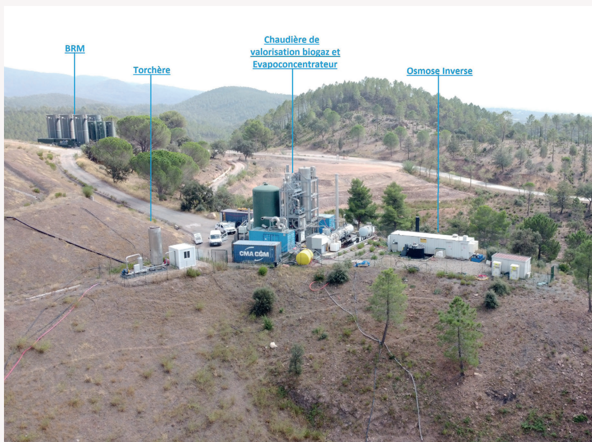
Equipements de traitement des lixiviats
